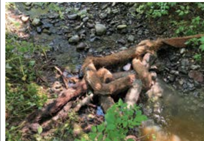
V Garbockom jarku sa na odkalenie vodovodu využíva samostatné potrubie. Od posledného odkaľovania celé zarástlo koreňmi rastlín.
